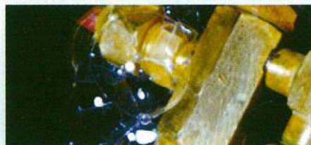
発泡液で漏えいを確認
