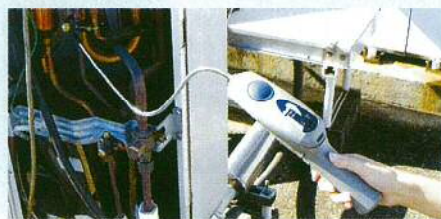
電子式漏えいガス検知器で漏えいを確認
