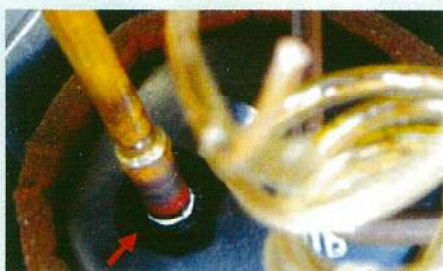
油漏れやしみて漏えいを確認
